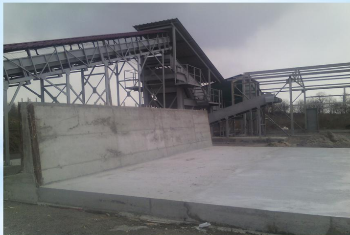
Сміттесортувальна дільниця в м. Калинівка
